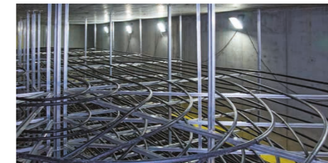
Blick in das Innere des Eis-Energiespeichers
